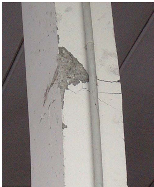
Il pilastro lesionato (fuori piombo)
